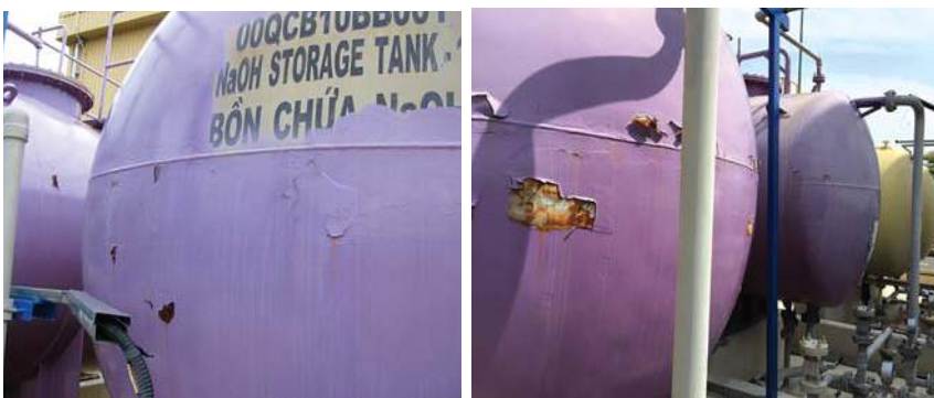
Hình 7. Bồn chứa NaOH tại Nhà máy Điện Cà Mau 1
