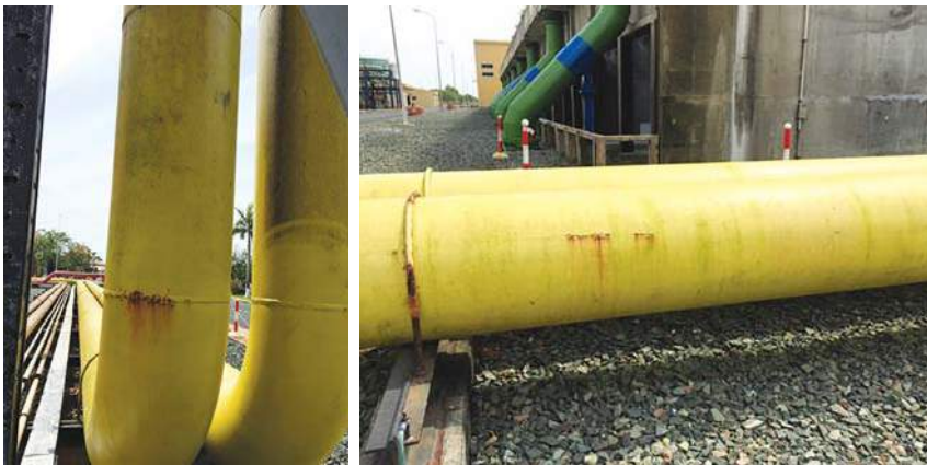
Hình 6. Đường ống dẫn khí Điện Cà Mau 1
