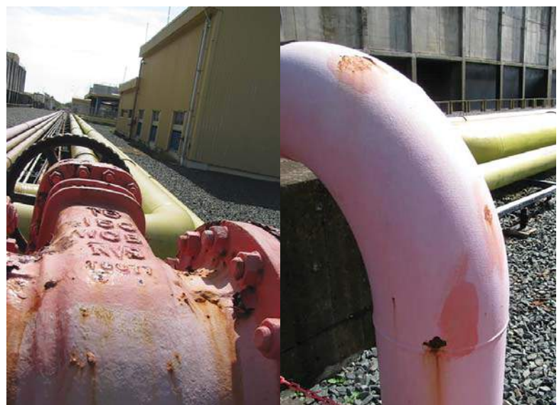
Hình 3. Bong tróc lớp phủ tại đường ống nước cứu hỏa Nhà máy Điện Cà Mau 1
